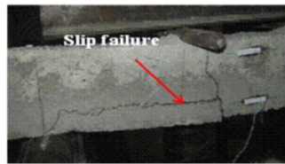
Gambar 8. Pola retak balok beton bertulang bambu hasil penelitian terdahulu
