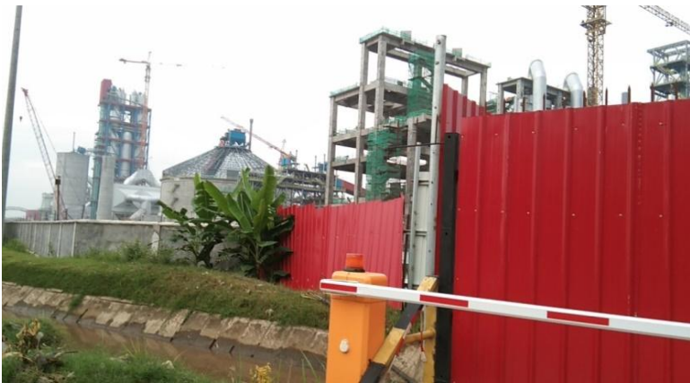
Gambar 4 Bangunan pabrik semen yang berada di atas saluran irigasi lama yang telah ditutup ( https://duniatambang.co.id/ForumKategori/read/1222/Relokasi-atau-Tambang )
