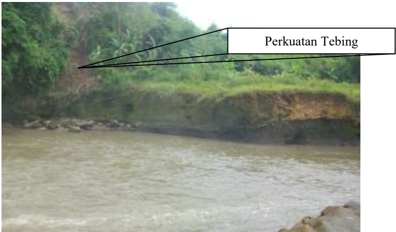
Gambar 6.41. Foto tebing sungai rawan longsor perlu perkuatan
