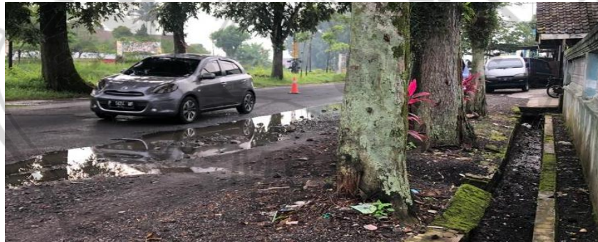
Gambar 1.1 kondisi drainase pada ruas jalan Jajag
