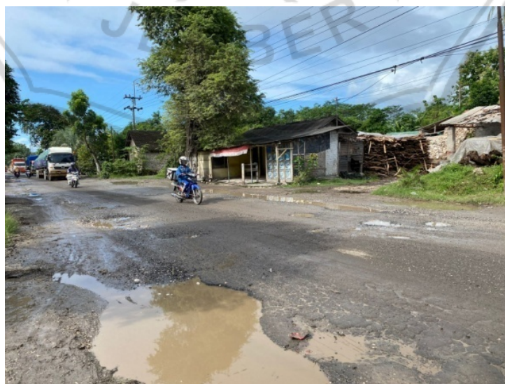
Gambar 1.1 Kondisi Kerusakan Jalan (Sumber : Dokumentasi Lapangana, 2023)
