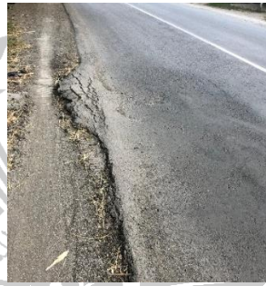
Gambar 1. 1 Bleeding pada aspal (Sumber : Dokumentasi Pribadi)
