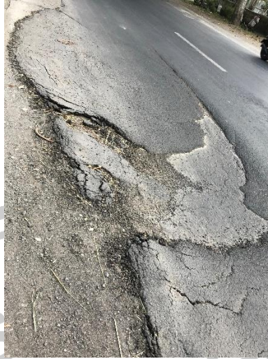
Gambar 1. 3 Jalan Berlubang, Bleeding dan retak-retak pada aspal
