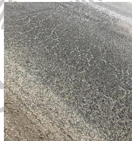
Gambar 1. 2 Retak-retak pada aspal (Sumber : Dokumentasi Pribadi)
