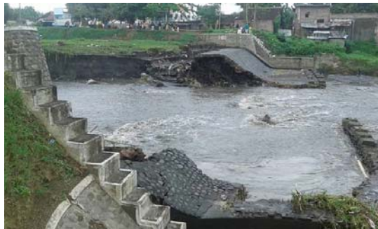
Gambar 1.1 Kondisi Bendung Boreng Saat Jebol
