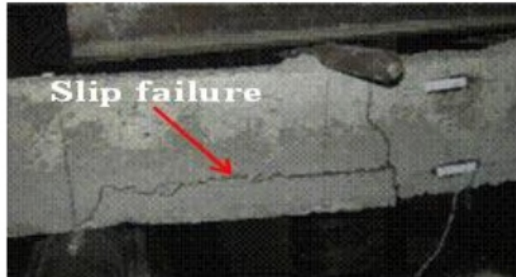
Gambar 1.5. Rambatannya retak beton bertulang bambu Sumber: Agarwal, Nanda, & Maity (2014, p.616)
