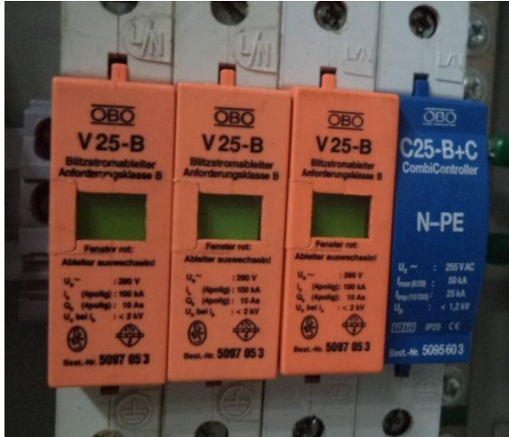
Gambar 4.8 Arrestor OBO V25 –B / V25-B+C SPD SPP internal yang terpasang adalah dengan menggunakan arrestor merk :
