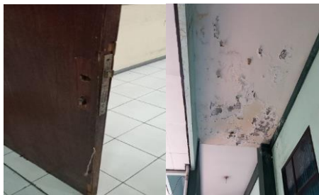
Gambar .4. Tingkat kerusakan ringan
