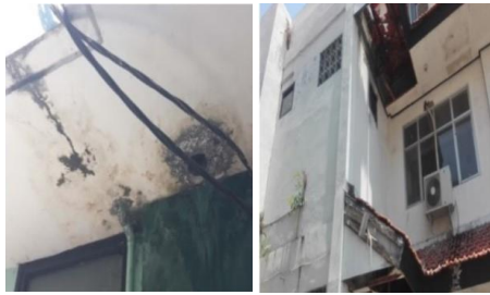
Gambar. 3. Tingkat kerusakan sedang
