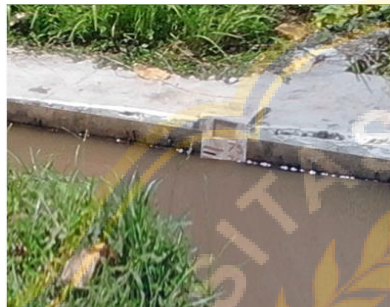
Gambar 4.14 Tinggi Muka Air Sesudah Pemasangan Alat Ukur Debit V-Notch
