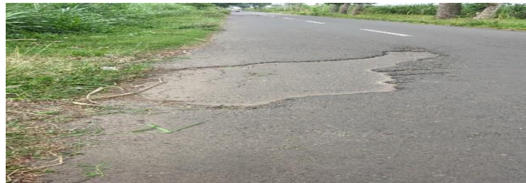
Gambar 1. 1 Kondisi Jalan (Sumber : Dokumentasi Pribadi)
