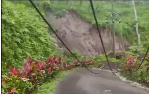
Gambar 1. 2 Kondisi Jalan Terdampak Longsor
